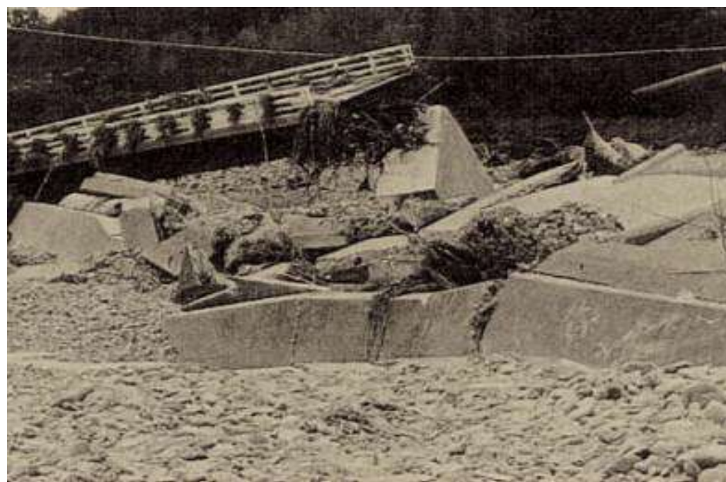
昭和47年7月洪水による派川虫追橋の被災状況
